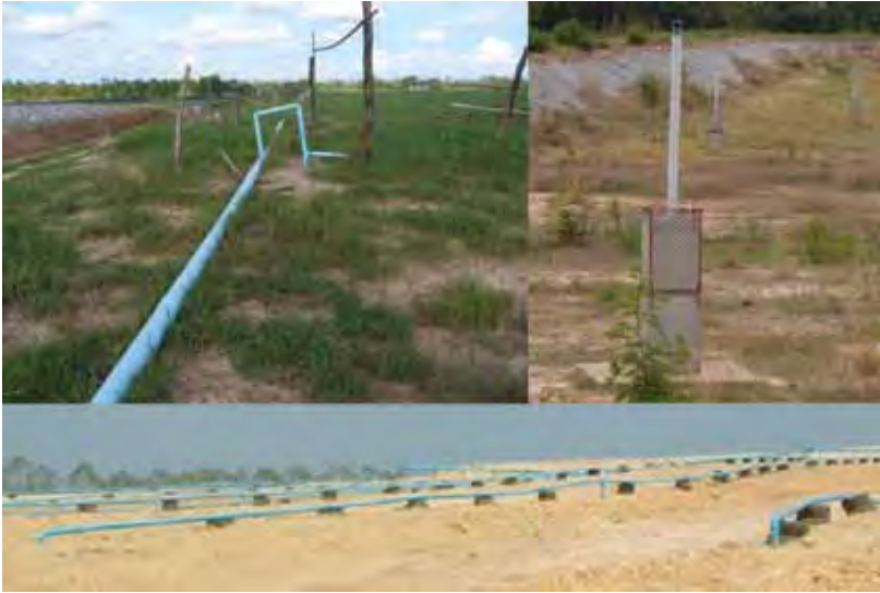
รูปที่ 23 ระบบรวบรวมและท่อระบายก๊าซ
